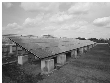
第四小学校屋上の太陽光発電
