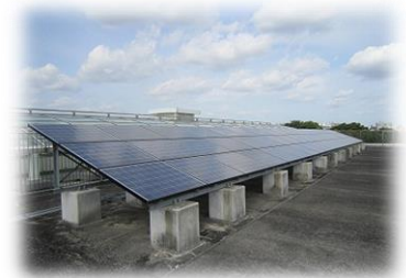
第四小学校屋上の太陽光発電
