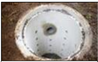
雨水浸透ます
