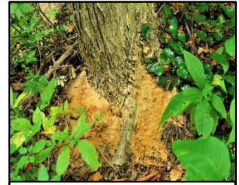
多量に発生したフラス
