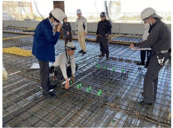
5階の議場手すりを固定するためのアンカーボルトの設置状況について確認しています。(10/20)
