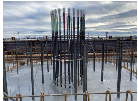
屋上に設置する防災行政無線鉄塔を固定するアンカーゲージが屋上床スラブに据え付けられました（11/17）
