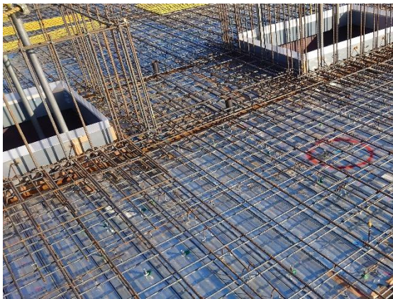
屋上床スラブの配筋は、構造図通り配筋されていることを確認しました。（11/8）
