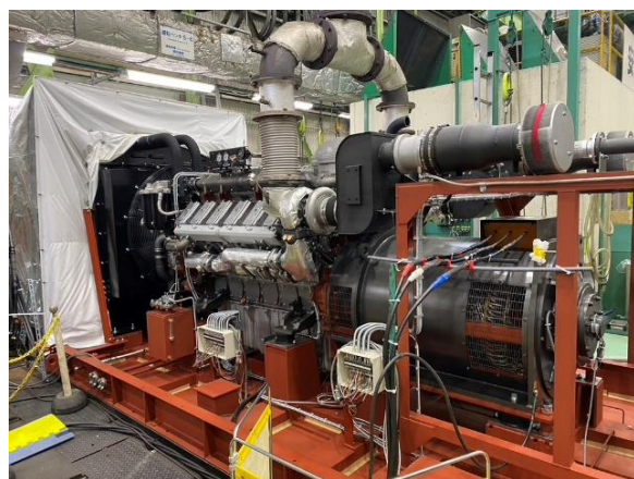
非常用(ガス混焼型ディーゼル)発電機の製品検査を行い、問題無く運転することを確認しました。(12/27)
