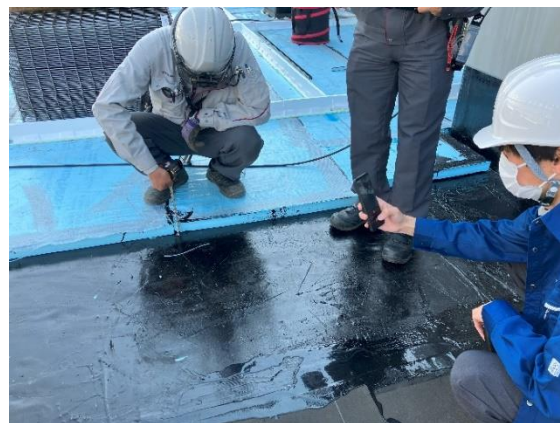
5階設備機器置場の断熱材は、適切な厚みが確保されていることを確認しました。(11/24)
