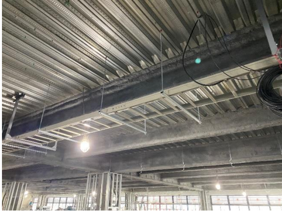
天井にはケーブルラックが設置されています。 (1/25)
