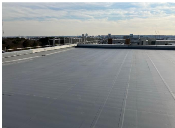
議場の屋根に防水シートが敷設されました。 この上に、太陽光発電パネルが設置されます。 (1/19)
