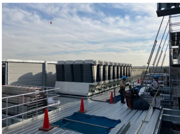
5階設備機器置場に、空調機器が設置されています。(1/19)
