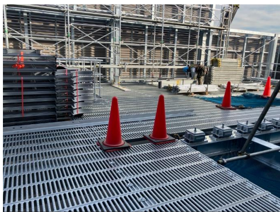
5階設備機器置場に、点検用鋼製床が設置されています。(1/19)
