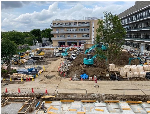
庁舎東側の多目的広場でも植栽工事や外構工事が 進んでいます。東面も外部足場は撤去されま した。(6/7)
