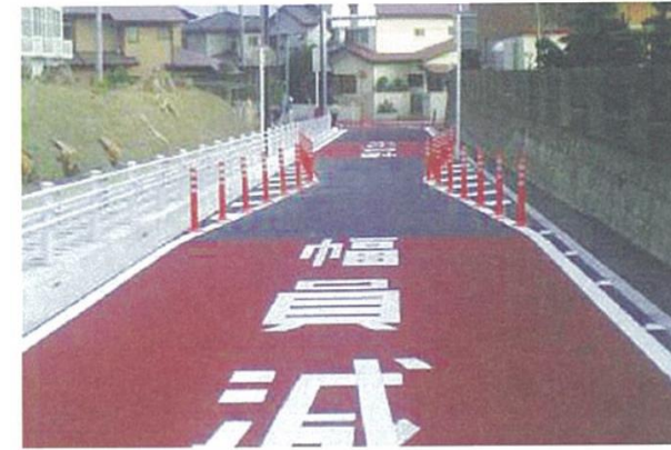
写真 2.2.2.21 狭さく（千葉県鎌ヶ谷市）
