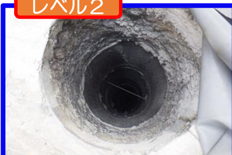
煙突内断熱材
